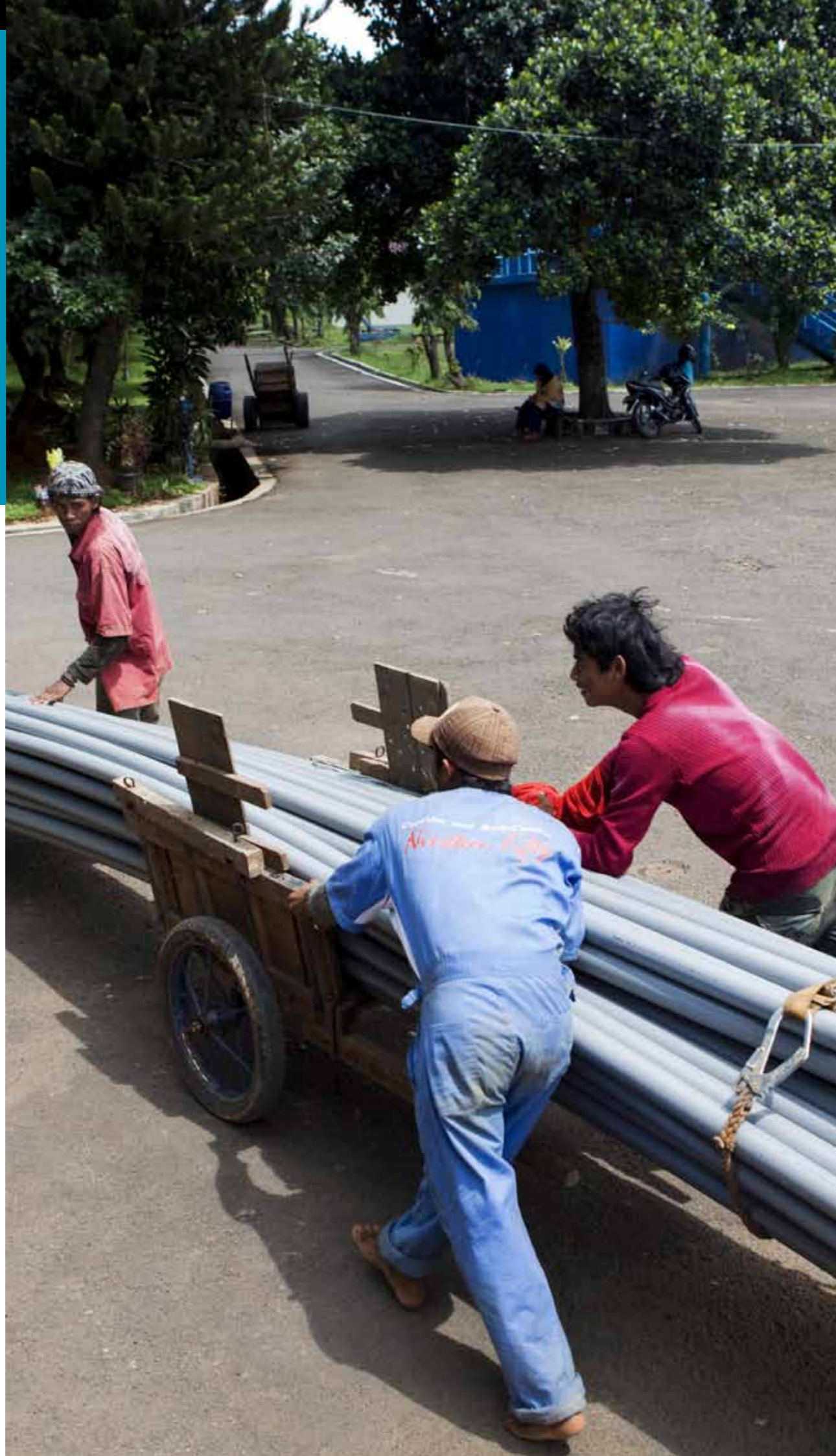
Medwerkers van Tirta Kahuripan vervoeren buizen voor de aanleg van nieuwe waterleidingen
